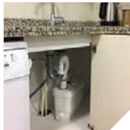
Tezgâhın altına gizlenmiş SANIVITE pompa
