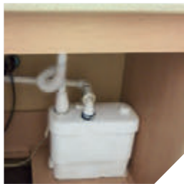
Mutfak eyesinin altına gizlenmiş SANIVITE pompa
