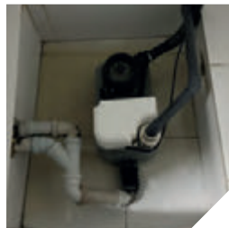
-1. kattaki depoya kurulmuş SANICOM 1
