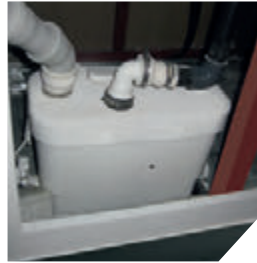
Alçıpan içine gizlenmiş SANISPEED pompa
