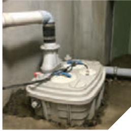
Montajı yapılmış SANICUBIC 2 VX
