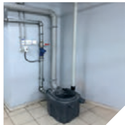
-2. katın zeminine kurulan SANIFOS 110
